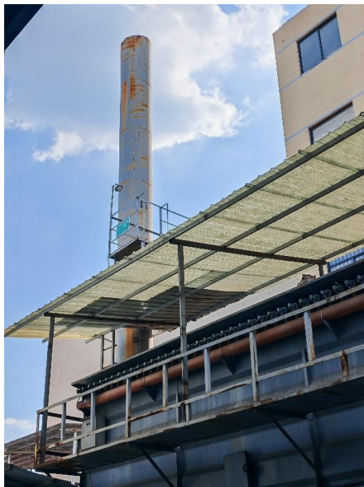
废气排放口（DA001）
