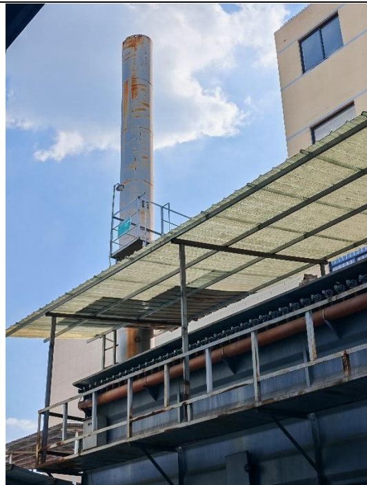
废气处理设施（高效布袋除尘器）
