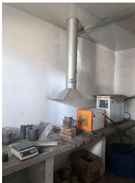
检测烟气收集装置（密闭房间+集气罩）
