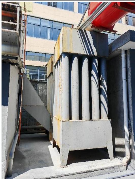
废气处理设施（竖管降温设施）
